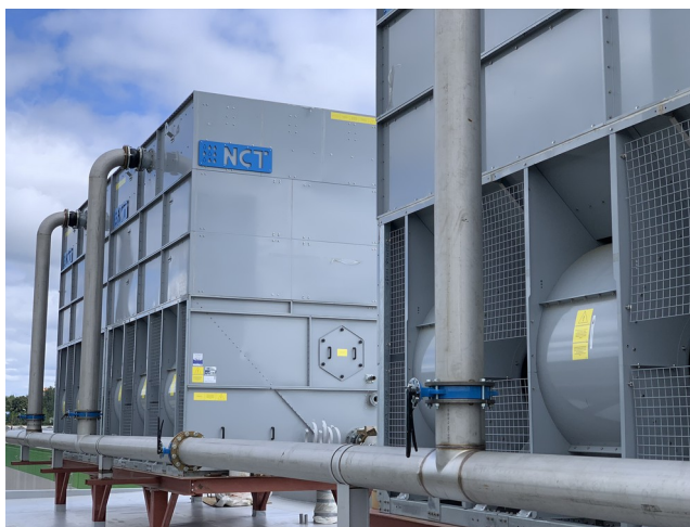
Закрытая градирня NCT на крыше промышленного объекта.
