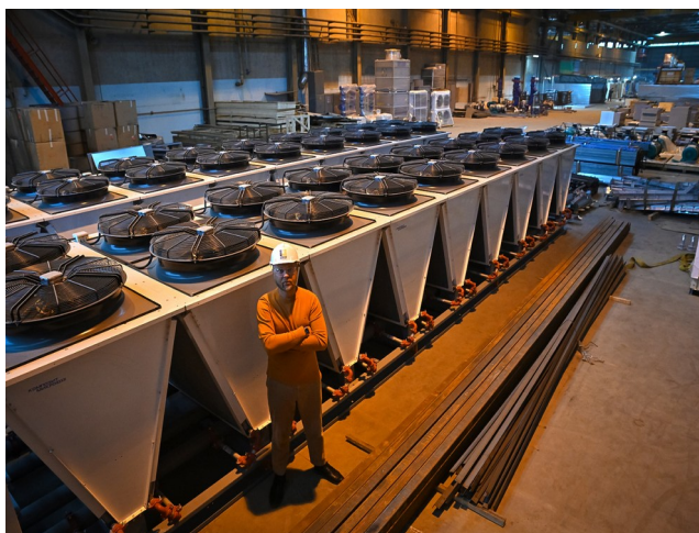
Сухие охладители (драйкулеры) NCT в производственном цеху. Они же используются в качестве free-cooling модулей в чиллерах
