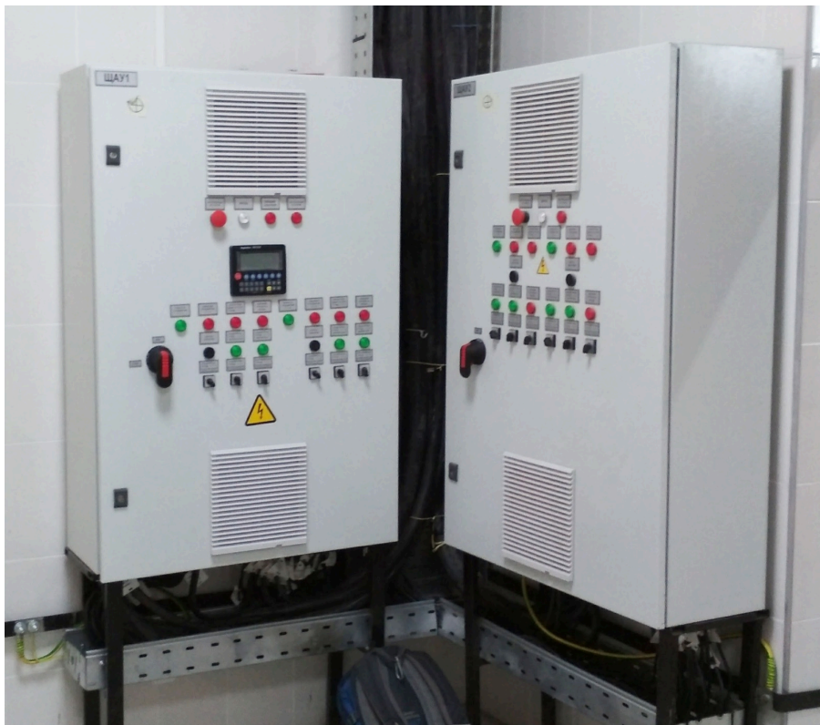
Рисунок 40 Щиты автоматики NCT на объекте: шкафы управления на подставках, кабели заведены снизу из лотков
