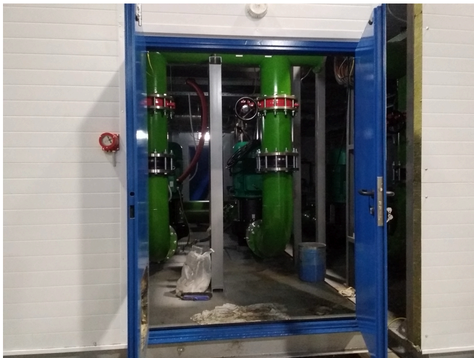
Рисунок 41 Внутри блочно-модульной насосной станции НСТ: насосы, коллекторы и арматура в утеплённом контейнере
