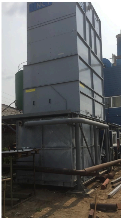
Рисунок 7 Сборный оцинкованный бак NCT под градирней: накопительный бак открытого контура на общей раме
