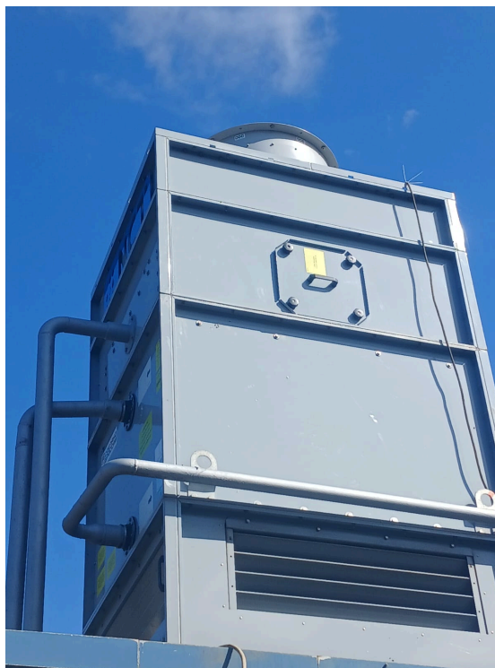
Рисунок 42 Испарительный конденсатор NCT на морозильном складе, Сахалинская обл.
