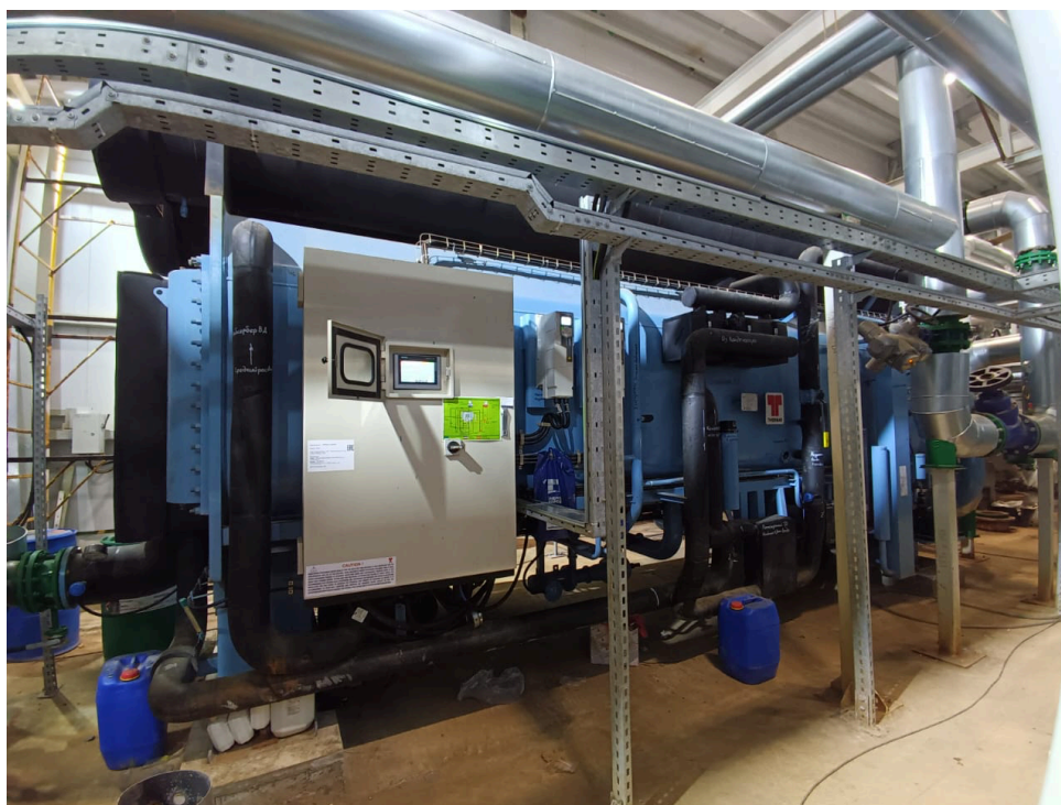
Рисунок 23 Абсорбционный тепловой насос Thermax на станции тепловых насосов Светлогорского ЦКК
