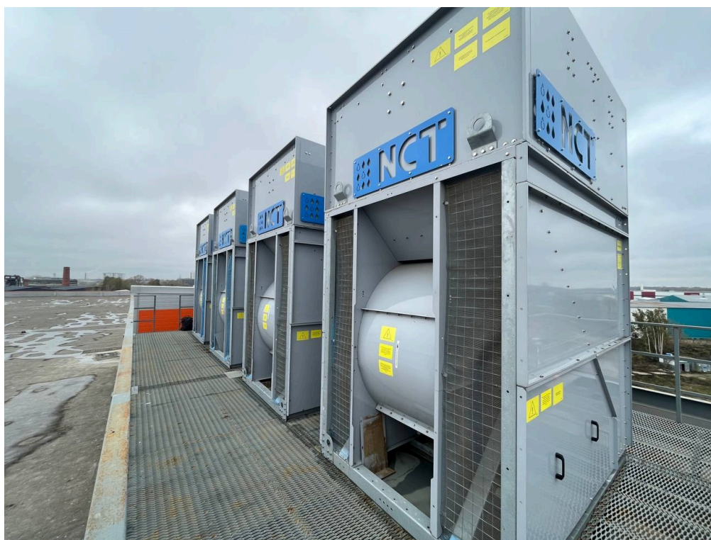
Рисунок 4 Открытые градирни NCT серии VR на кровле: центробежные вентиляторы в нижнем сухом отсеке
