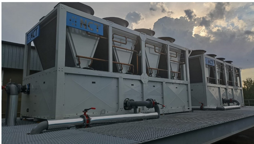
Чиллеры NCT с воздушным охлаждением на объекте. У воздушных машин главный летний риск — забитый конденсатор и вентиляторы.
