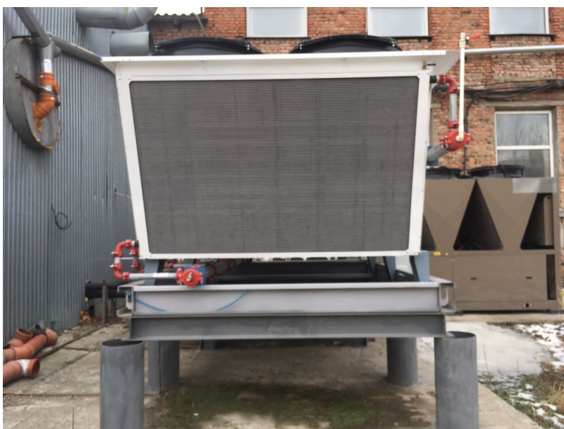
Лицевая поверхность оребрённого теплообменника драйкулера NCT. Именно здесь оседают пыль, пух и грязь — и работают как одеяло, мешая сбросу тепла.
