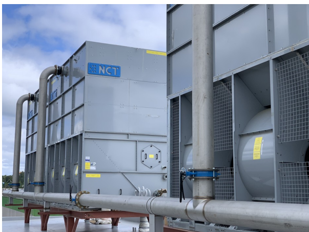
Закрытая градирня NCT на крыше объекта
