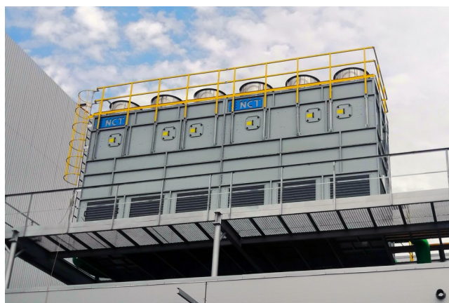
Закрытая градирня NCT на крыше промышленного объекта — конструкция, рассчитанная на круглогодичную работу в РФ.
